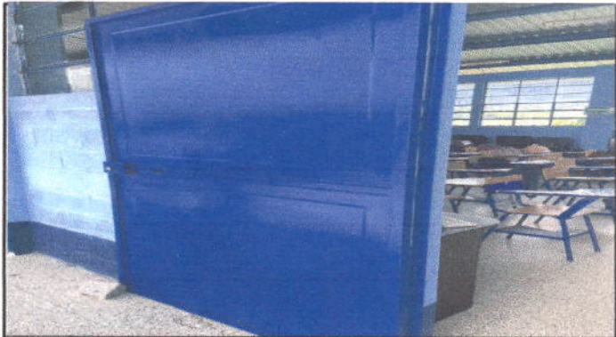
Foto 3: Mantenimiento a estructura de 9 puertas de metal (lijado y aplicación de pintura) y sustitución de dos chapas.
